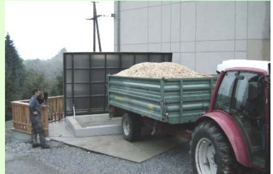
Spazio di stoccaggio di cippato con copertura
