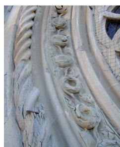
Particolare del rosone prima del restauro
